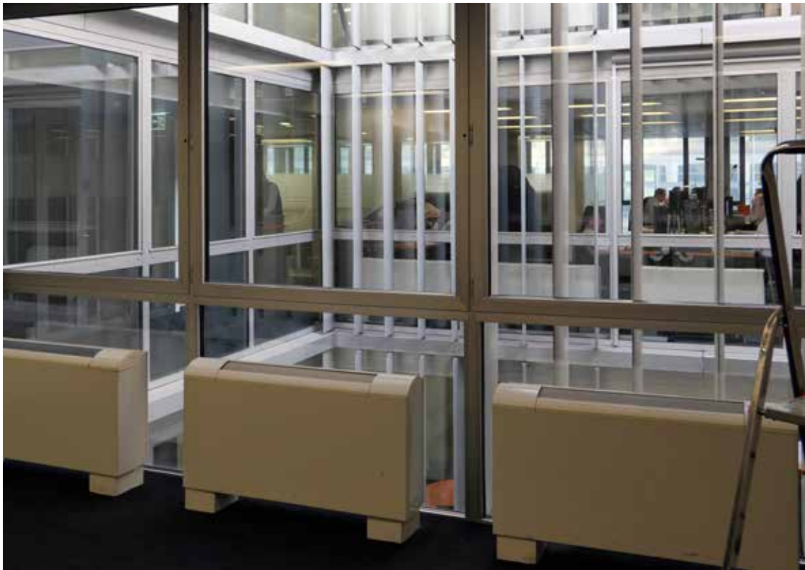
Ventilo-convecteurs d'origine placés sous les fenêtres côté cours (photo Y. Delemontey, 2020).
