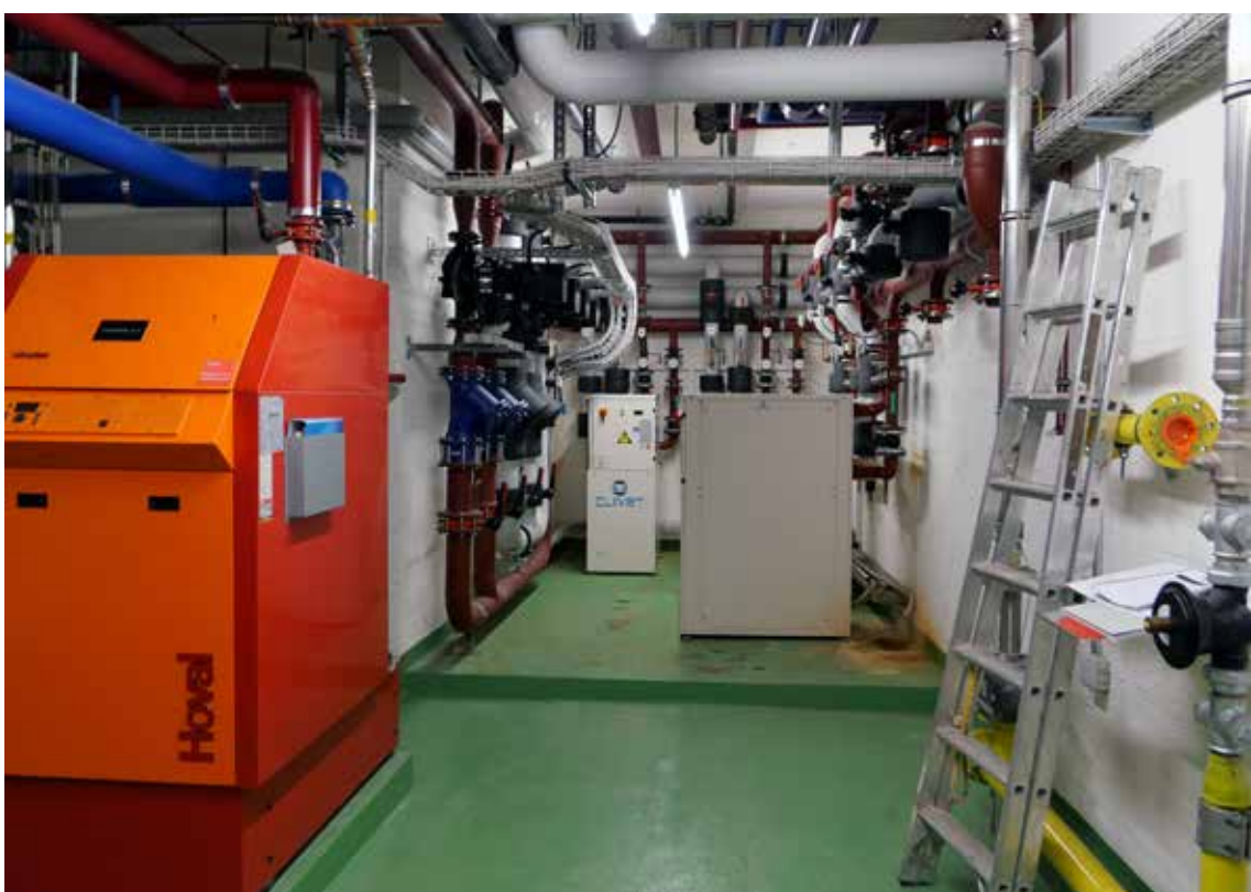
Chaufferie installée au deuxième sous-sol (photo Y. Delemontey, 2020).
