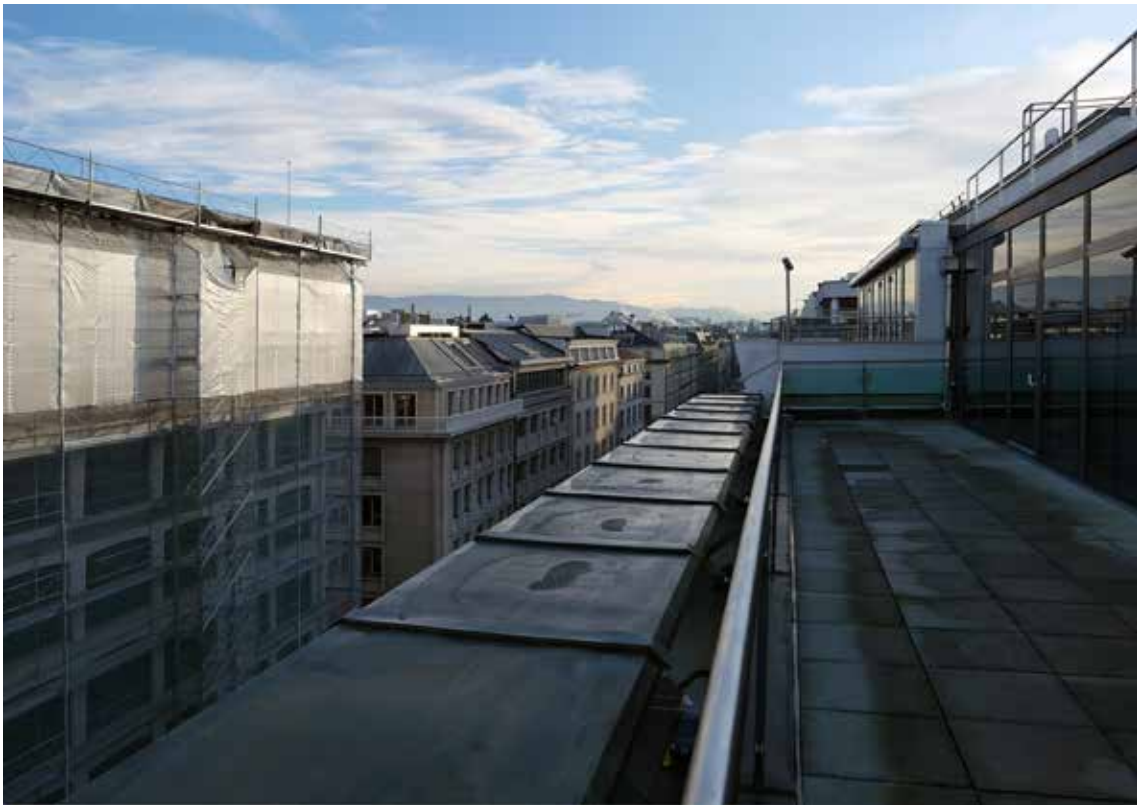
Corniche d'origine revêtue d'une ferblanterie interdisant désormais toute plantation (photo Y. Delemontey, 2020).
