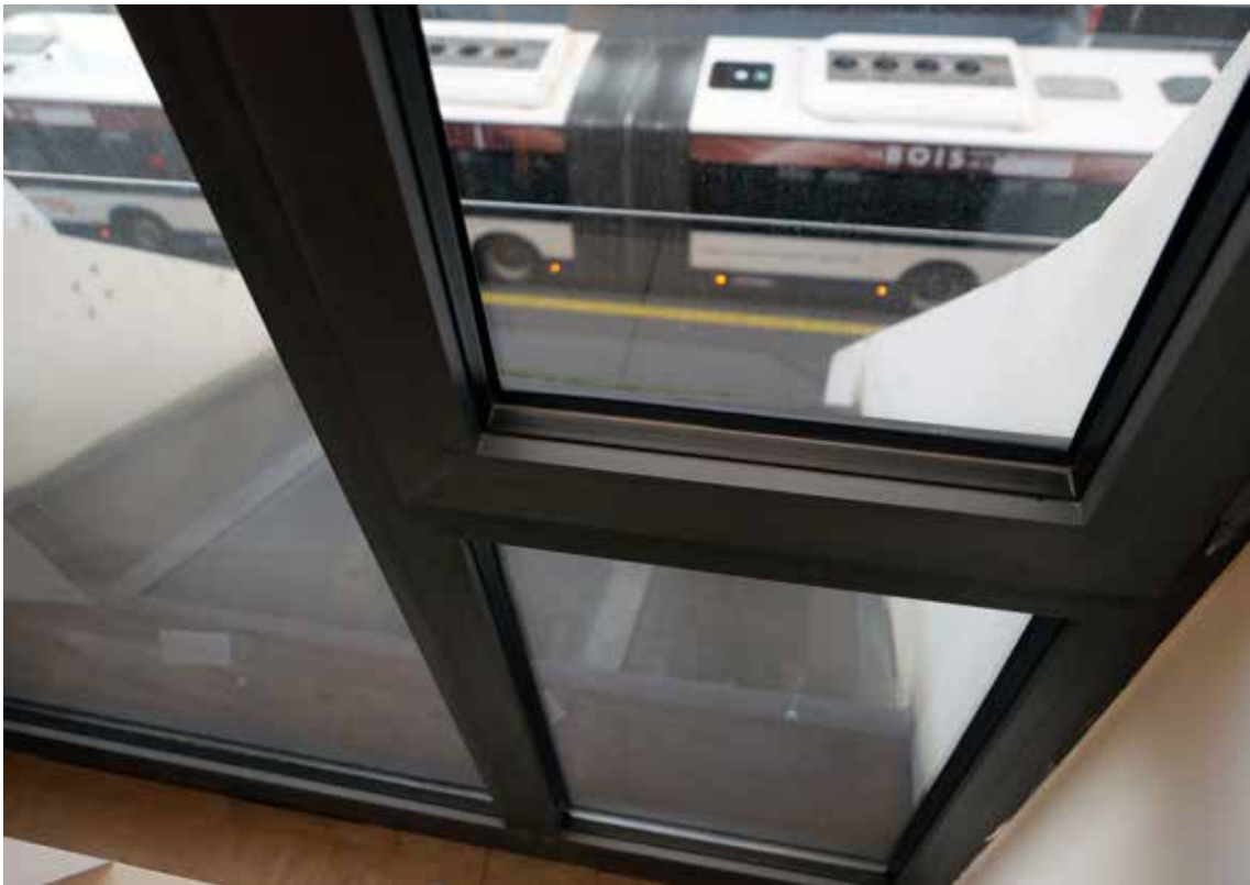
Détail des châssis vitrés en aluminium eloxé côté rue du Rhône (photo Y. Delemontey, 2020).
